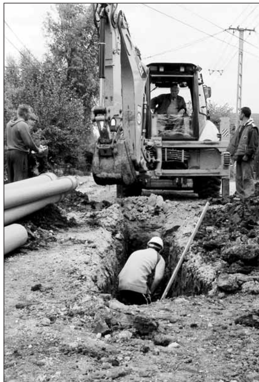
A talajvíz „eltüntetése” után, ember és gép együtt dolgozott a csatornacső lefektetésén
